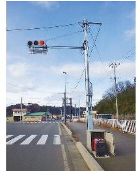
常設型発動発電機ボックス
